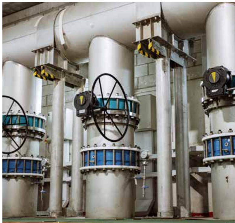
↑ Conducciones bombeo, EDAR Gijón Este.
