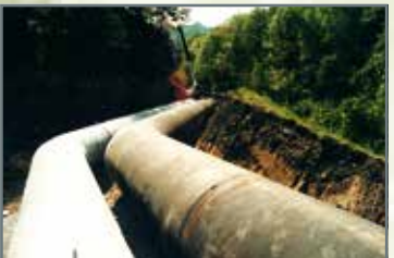
Derivación principal en Rozadas. Conducción desdoblada.
