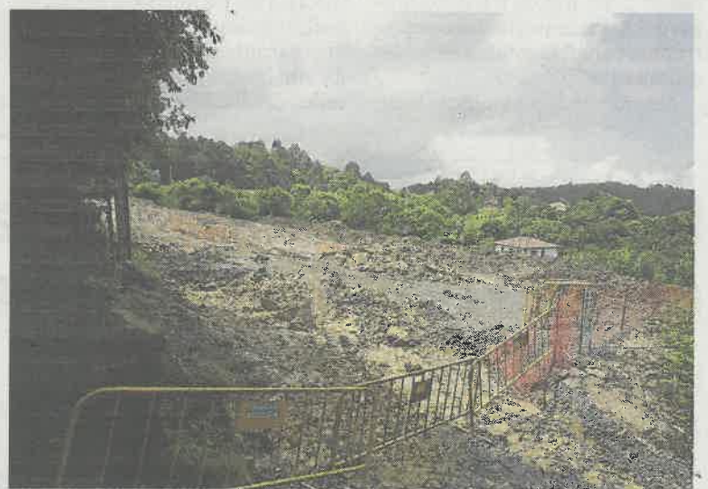
Fomento trabaja para instalar un sistema de control de infiltraciones en El Fabar, en las inmediaciones de la depuradora de Berbes. :: N. A.
