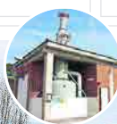
Torne de neutralización de cloro del depósito de Celles (Siero)
