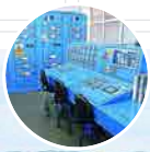
Sala de control de la planta de bombeo de Lamsanti (Sanjojo)
