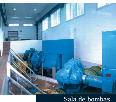
Sala de bombas
